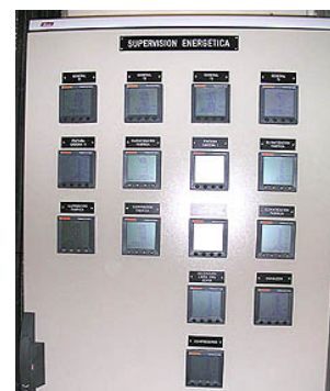
armari de visualització de la supervisió energètica
