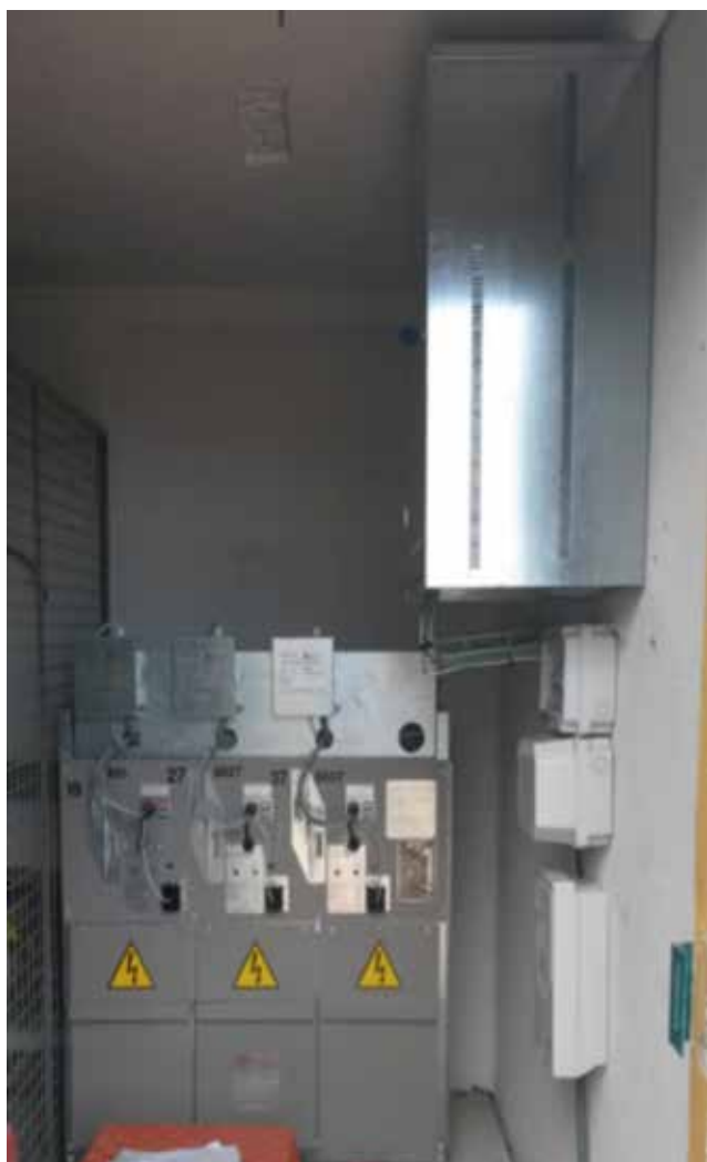
Centro de transformación telemandado
