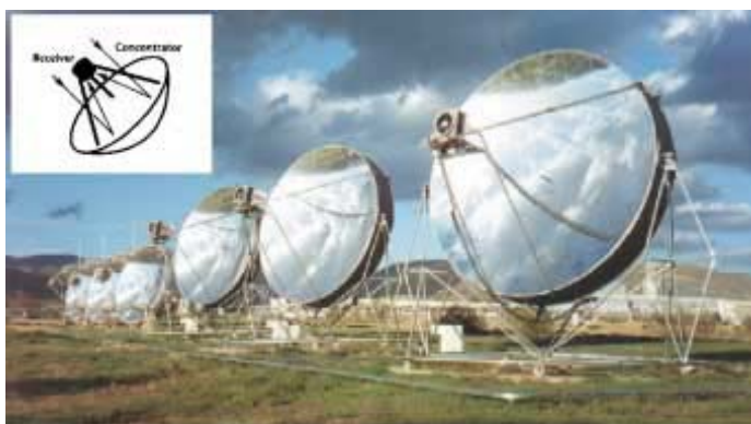
Sistemas termosolares de concentración del tipo “disco parabólico”.
