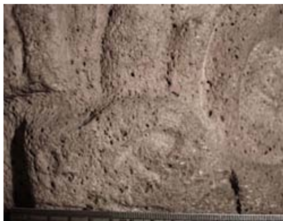
E. Microcavidades (pitting) (67%) ID06. Microcavidades que, en este caso, abarcan prácticamente toda la superficie de la escultura.
