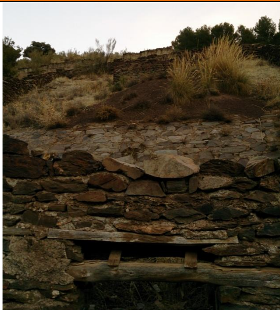
Rampa per on antigament feien caure la roca amb mineral de ferro
