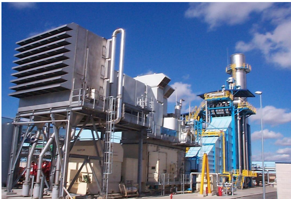
Figura 12.4.1 Planta de cogeneració.
