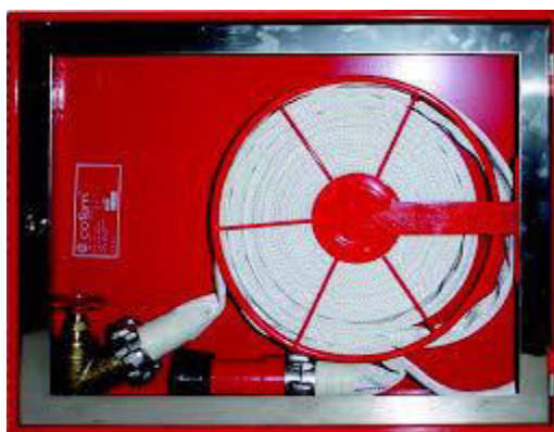
Figura V – 15. Boca d'incendi equipada BIE-45.
