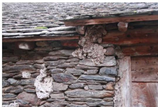
Imatge 7.2.17: Detall de trossos de ciment a la paret
