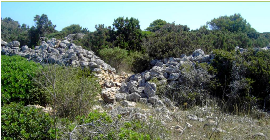
Imatge 7.12: Paret seca en mal estat on es pot observar un exemple d'enderrossall superior a un metre d'amplada. Font: CC'08
