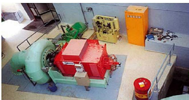
Figura 1.6: Imatge de la turbina minihidràulica. Font: Projecte Minihidràulica Los Hurones
