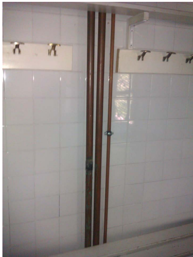
Millora 4 : Protecció i aïllament tèrmic del tubs d'aigua calenta
