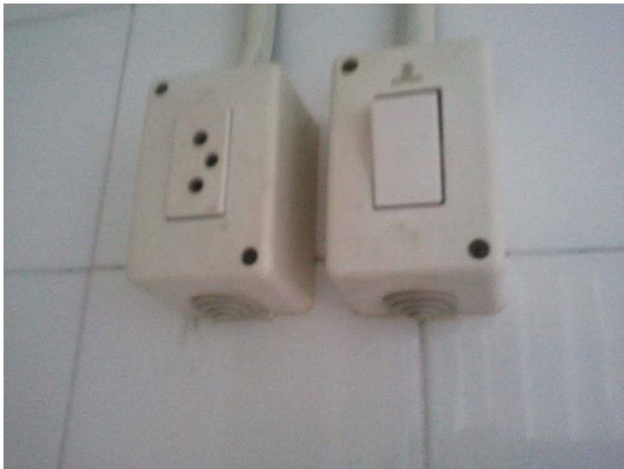
Millora 6: Protecció dels endolls en vestidors i lavabos
