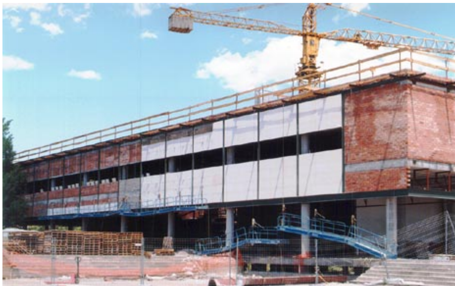
Edifici de les associacions d'estudiants. Les obres de la plaça Cívica estan en fase d'acabament. Les associacions d'estudiants ja tenen la distribució d'espais, i els locals amb diferent serveis ja s'han adjudicat. A la fotografia es pot veure l'estat de les obres al final de juny.
