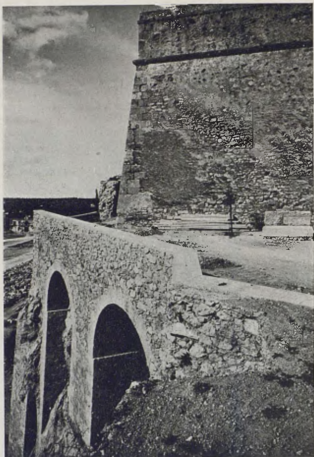
Reparació del camí, vora el «Fortí Negre». Any 1933. Ha calgut construir quatre arcades grans per a obtenir un lloc de pas suficient
