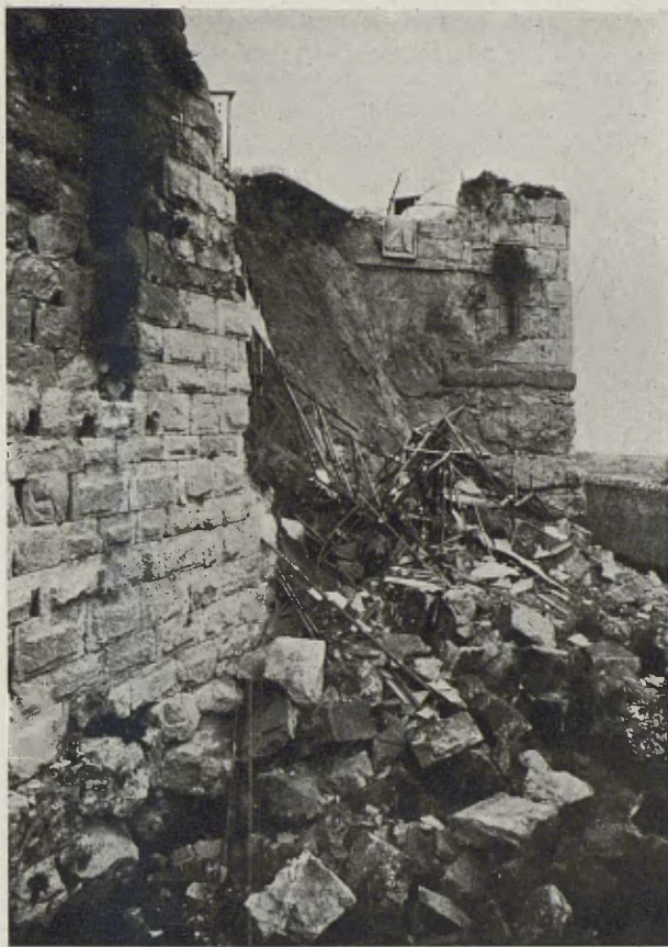
Enderroc del parament i esllavissada del massís interior de la muralla vora la torre de Sant Magí
