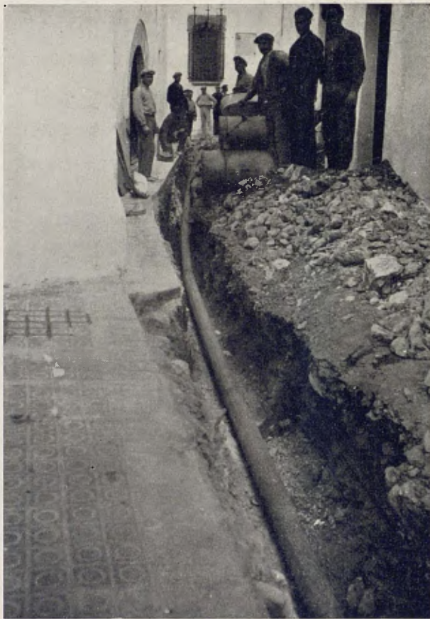
Obres d'aportació d'aigua per al servei d'extinció d'incendis al «Cau Ferrat»
