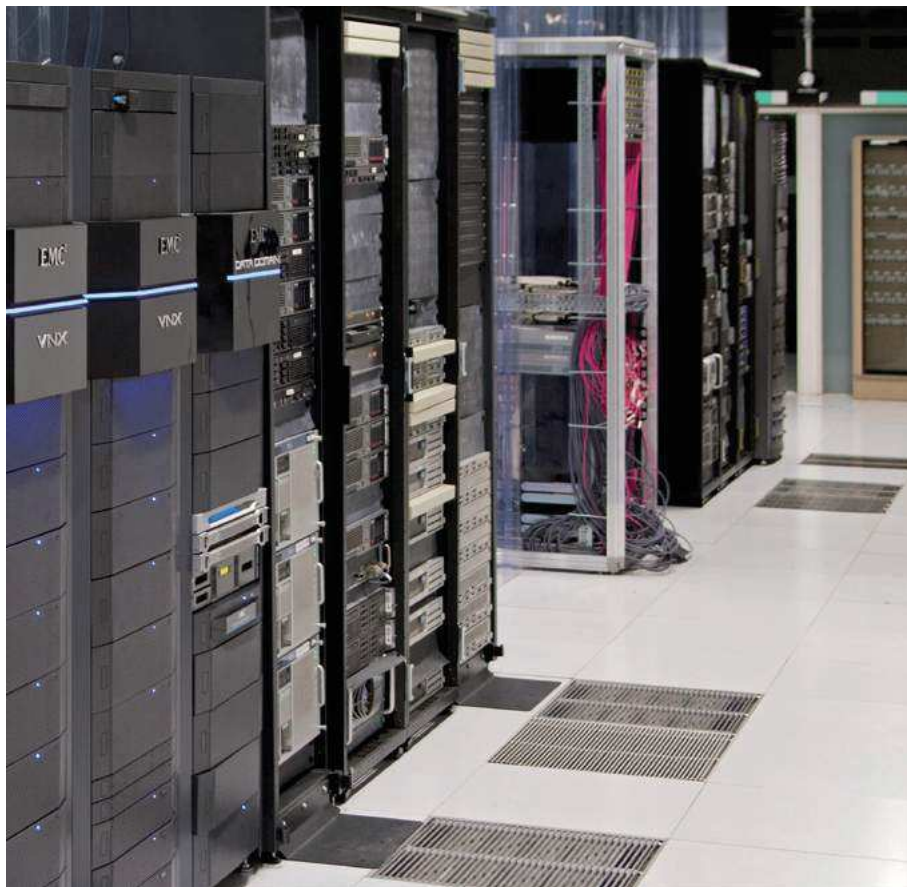
Instal·lacions al Servei d'Informàtica.
