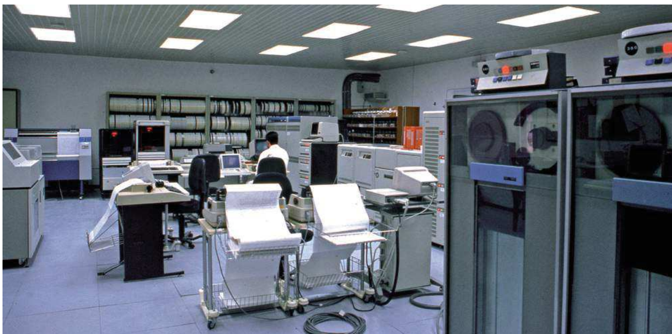
Sala de màquines del Servei d'Informàtica, l'any 1991.
