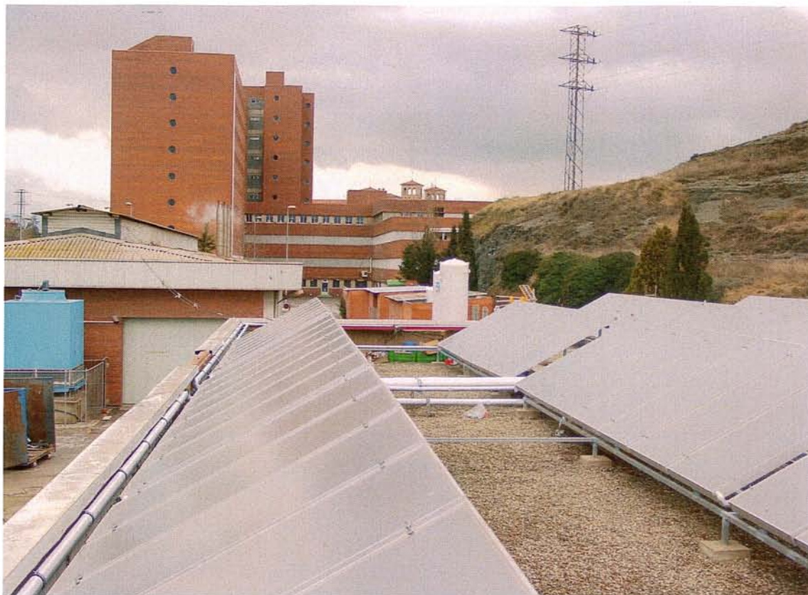
Imatge 1. Plaques solars de l'HGV damunt el sostre de manteniment
