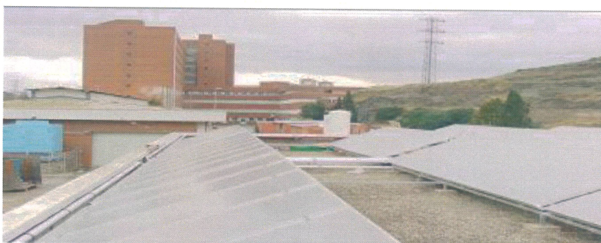
Imatge 1. Plaques solars de l'HGV damunt el sostre de manteniment
