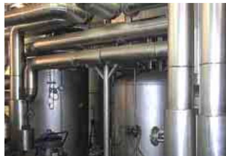
Sala de calderes (oli tèrmic)
