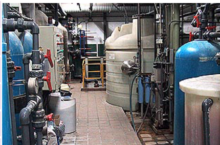
Planta Tractament d'aigua industrial d'entrada
