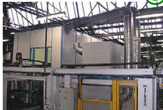
Vista del filtre absolut de la cabina de fums línia CRN-Serra
