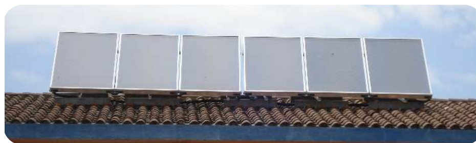
planta solar tèrmica (A.C.S. + calefacció) vestidors centrals
