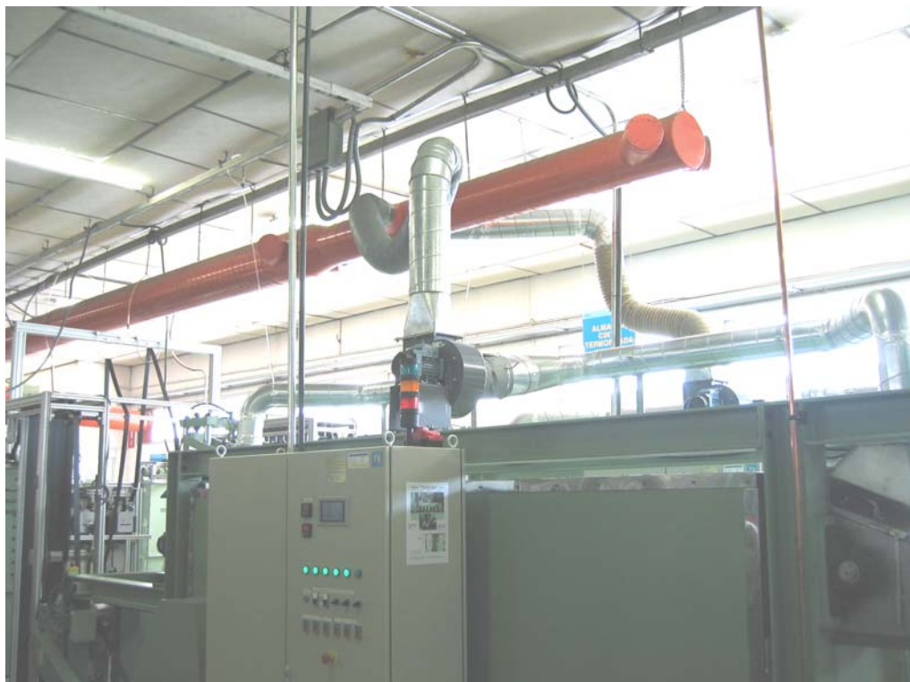
Vista del Sistema de extracción de humos. Horno de termofijar
