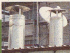
XEMENEIES DE LES CALDERES DELS SERV. CENTRALS DIAGONAL
