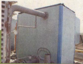
TORRE DE REFRIGERACIÓ DELS SERV. CENTRALS DE DIAGONAL
