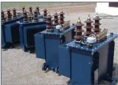
Parque fotovoltaico de Bargas, Toledo.
