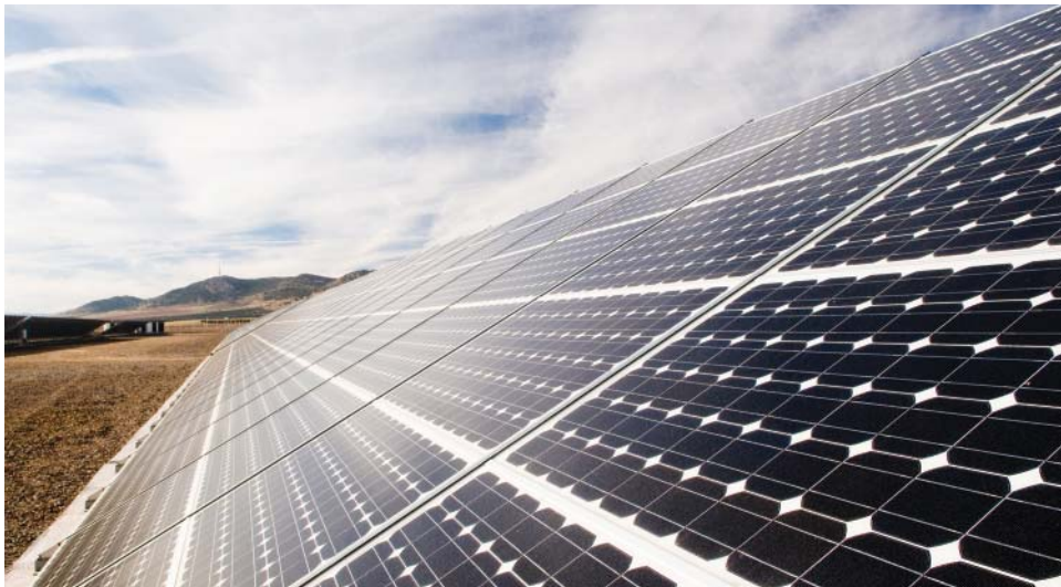
Parque fotovoltaico. Herencia, Ciudad Real.
