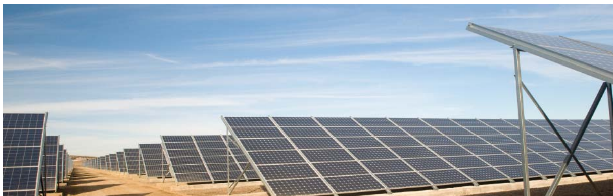
Parque fotovoltaico de Herencia
