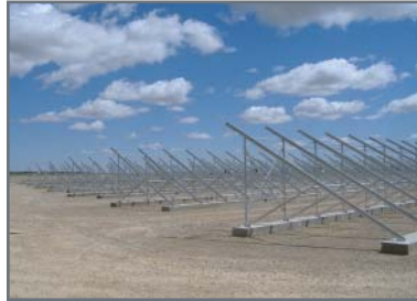
Parque fotovoltaico de Herencia, Ciudad Real.
