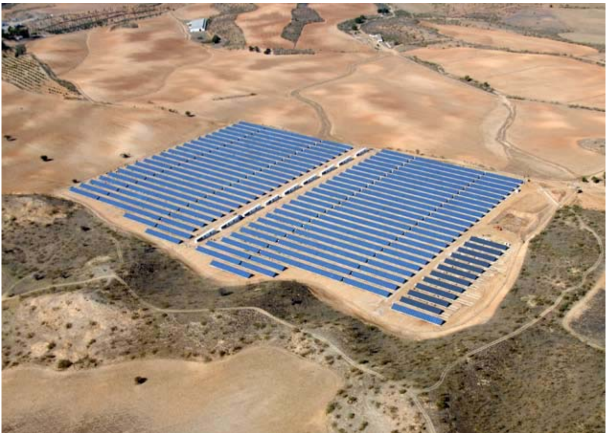
Parque fotovoltaico de Bargas, Toledo.
