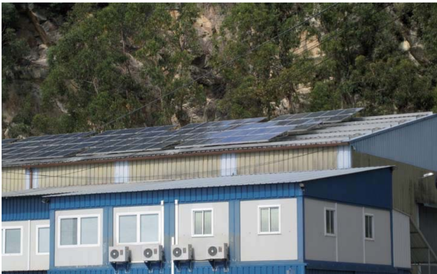
Instalación fotovoltaica sobre cubierta de Moa, Pontevedra.
