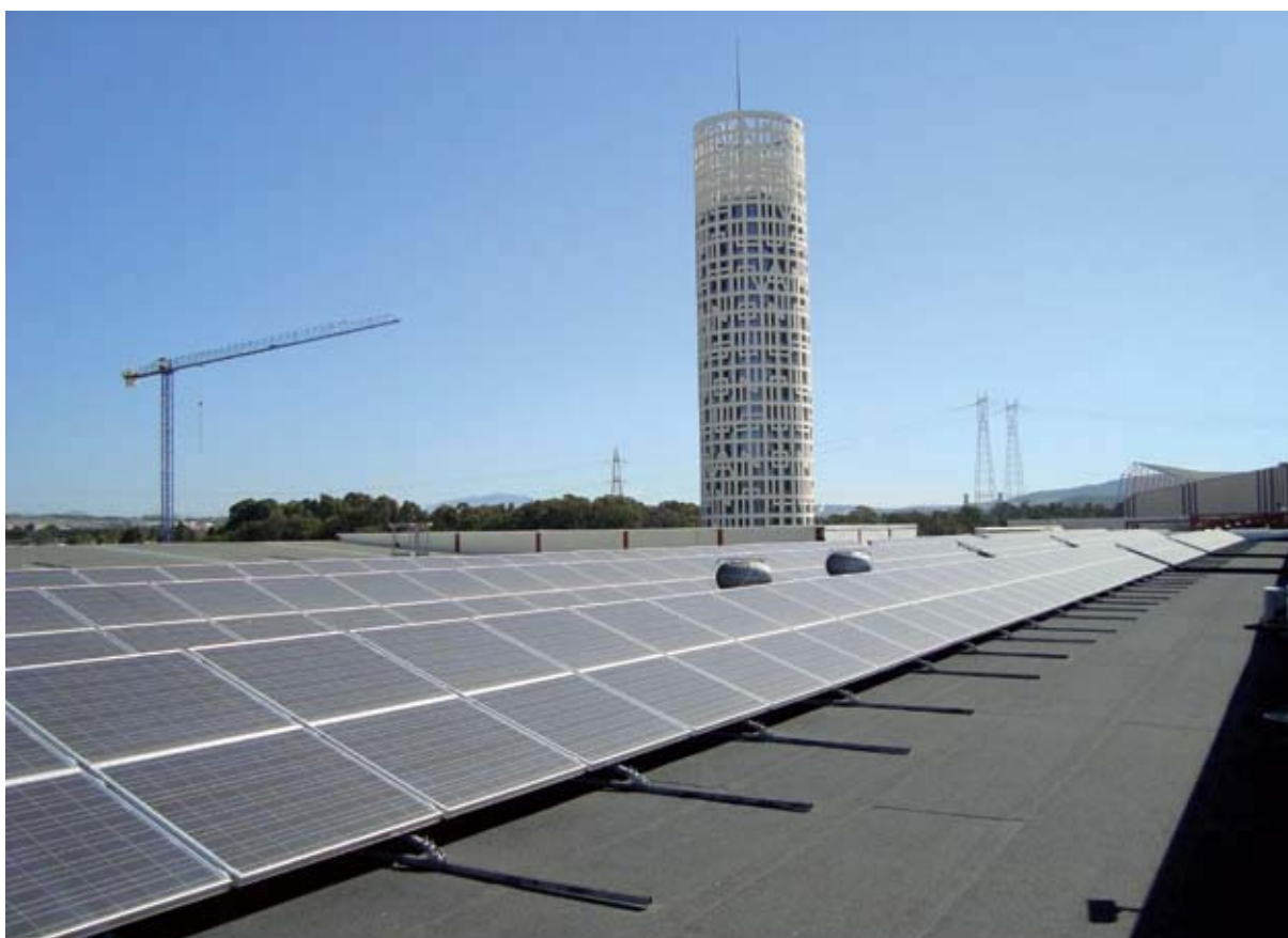
Instalación fotovoltaica sobre cubierta en Los Barrios, Cádiz.
