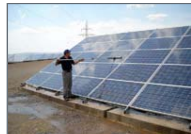
Labores de operación y mantenimiento de un parque.
