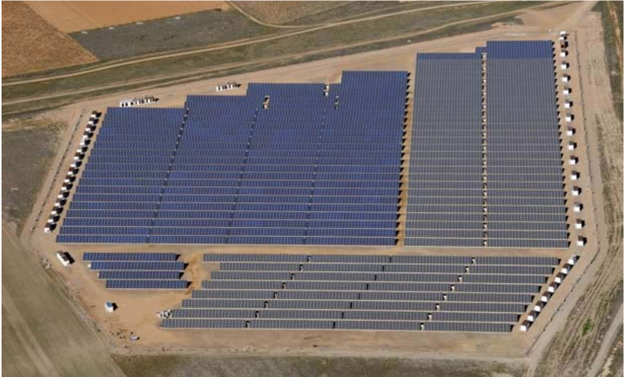
Parque Fotovoltaico de Herencia, Ciudad Real.
