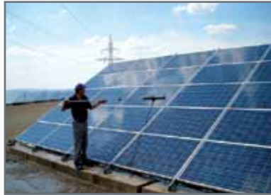
Cierre año 2008 de Operación y Mantenimiento. Bonificaciones en todos los parques.
