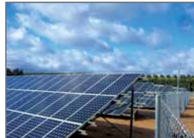
Inicio de las labores de Operación y Mantenimiento del parque de La Carolina
