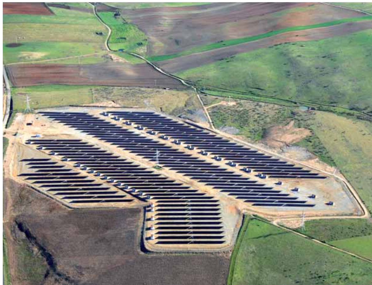
Parque fotovoltaico de Abenójar
