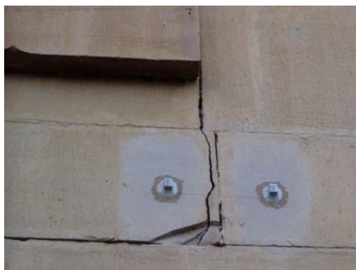
Referencia fisuración en obra de fábrica
