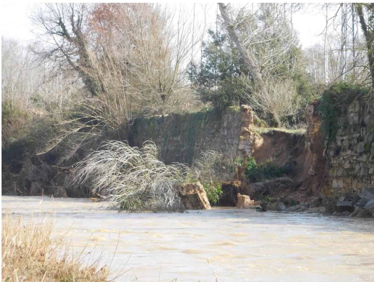
Mur de pedra i mota del marge esquerra de la riera de Santa Coloma, al sud del pont de la GI-555, després del temporal Glòria (2020). Actualment el mur es troba en molt mal estat de conservació
