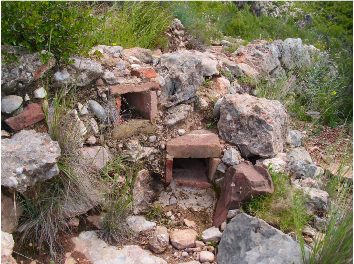
Detalle: muros en márgenes de piedra y desagües de obra, para canalizar el agua de lluvia recogida en una ladera de la vertiente sur de Montserrat
