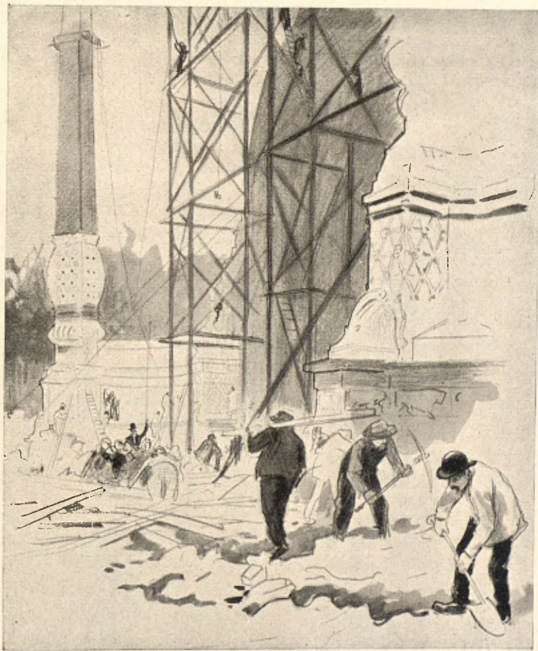
Aspecto que ofrecía la entrada monumental el día 13 de Abril, 24 horas antes de la inauguración, en cuyo acto apareció completamente terminada
