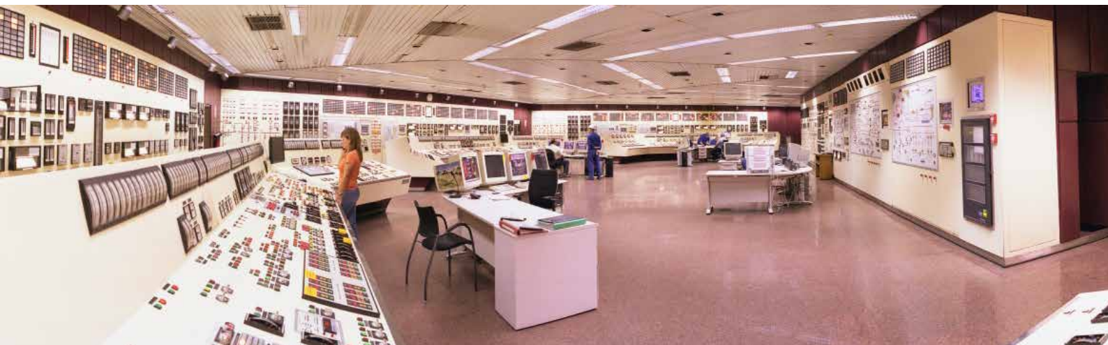
Central térmica de Andorra
