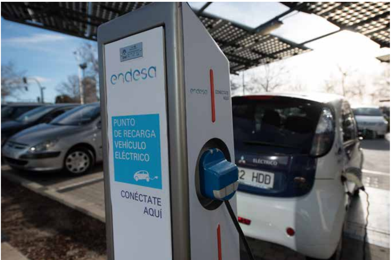
Punto de recarga para vehículo eléctrico
