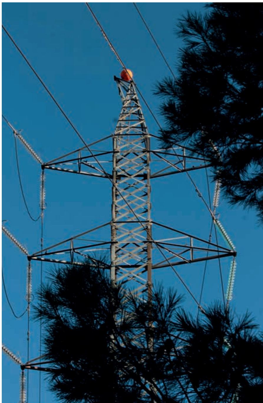
Línea de distribución de alta tensión
