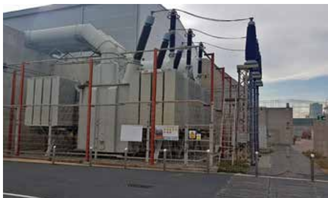
Sistema de monitorización en continuo del transformador principal del Grupo 3 de la central de Besós.
