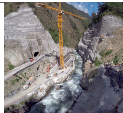
■ ■ Hidroeléctrica de Xacbal Delta, en Guatemala, de 57,7 MW.
