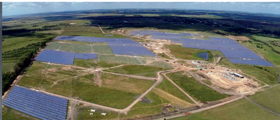
■ ■ ■ Planta solar fotovoltaica La Jacinta Solar, Uruguay.
