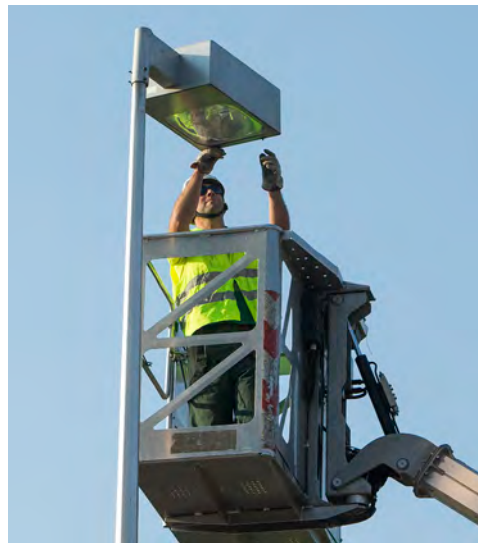
Mantenimiento de alumbrado.
