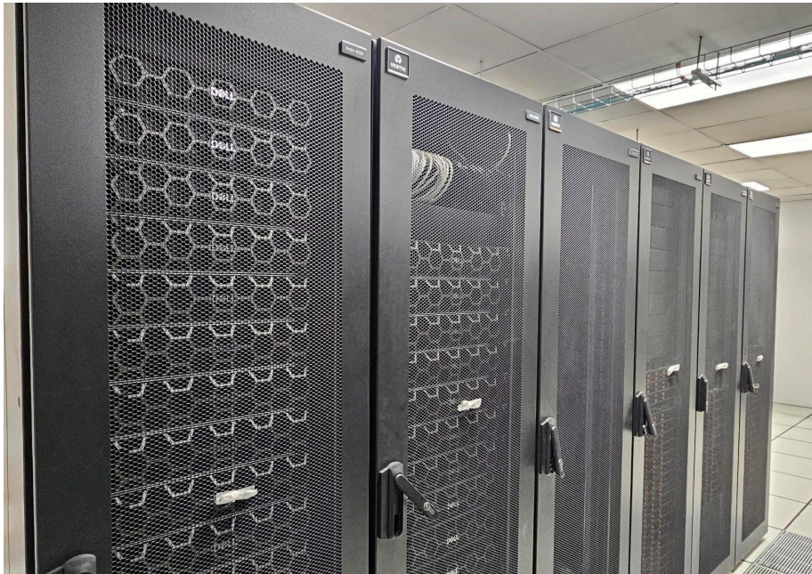
S'ha instal·lat Pirineus III , que estarà operatiu el 2024.
