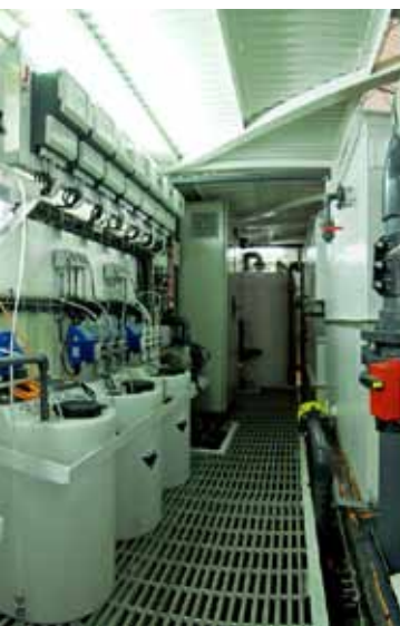
Planta piloto de pretratamiento de agua de mar con membranas
