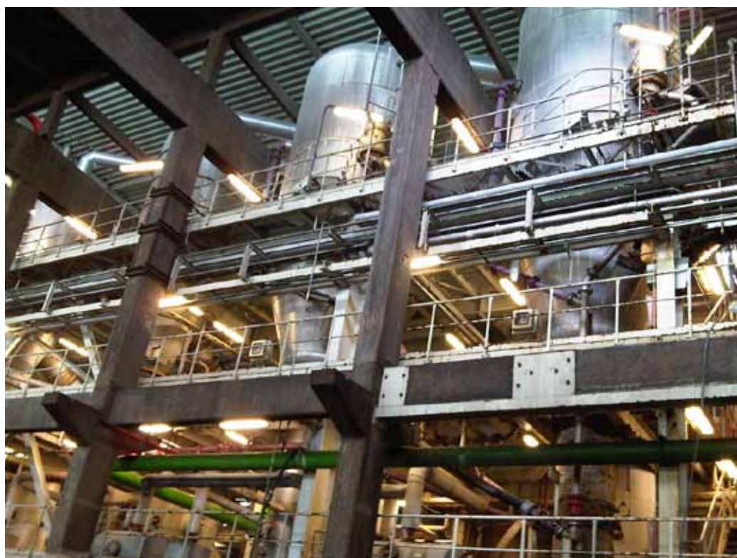
Evaporadores en planta de escorias salinas de Befesa Salzschlacke en Lünen, Alemania
