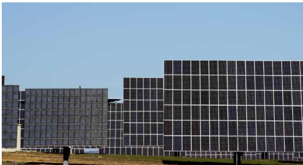
Planta fotovoltaica compuesta por heliostatos convencionales y de alta concentración operando en la Plataforma Solúcar, Sevilla
