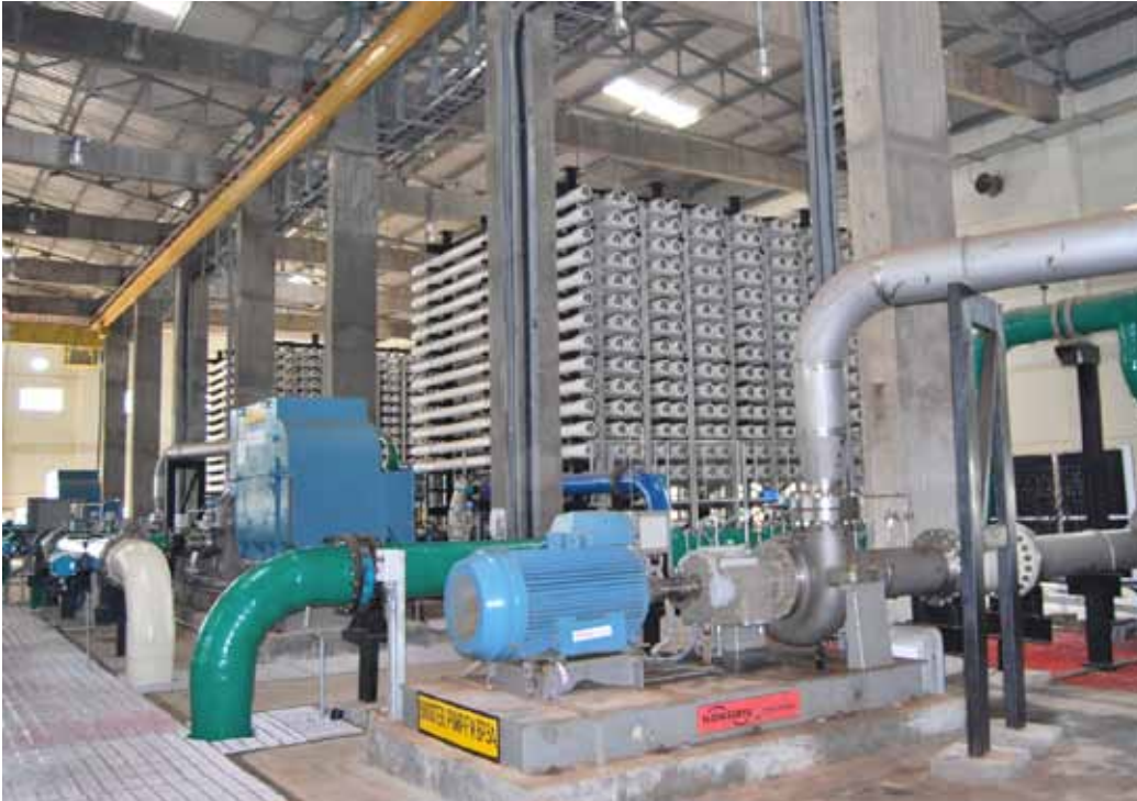
Bastidor de membranas y equipos de la desaladora Chennai, India
