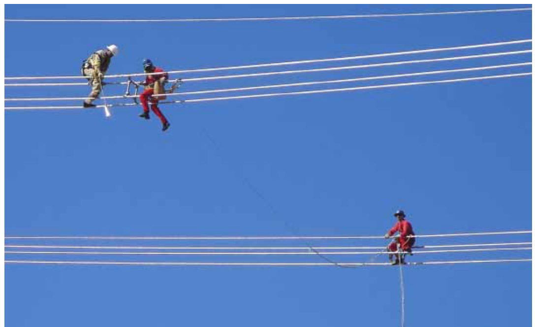
Empleados de Abengoa Brasil realizando tareas de O&M en una línea de transmisión
