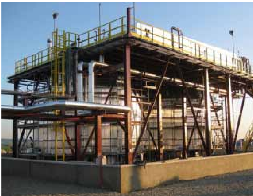
Planta de demostración de almacenamiento de sales en operación desde 2009 en la Plataforma Solúcar, Sevilla
