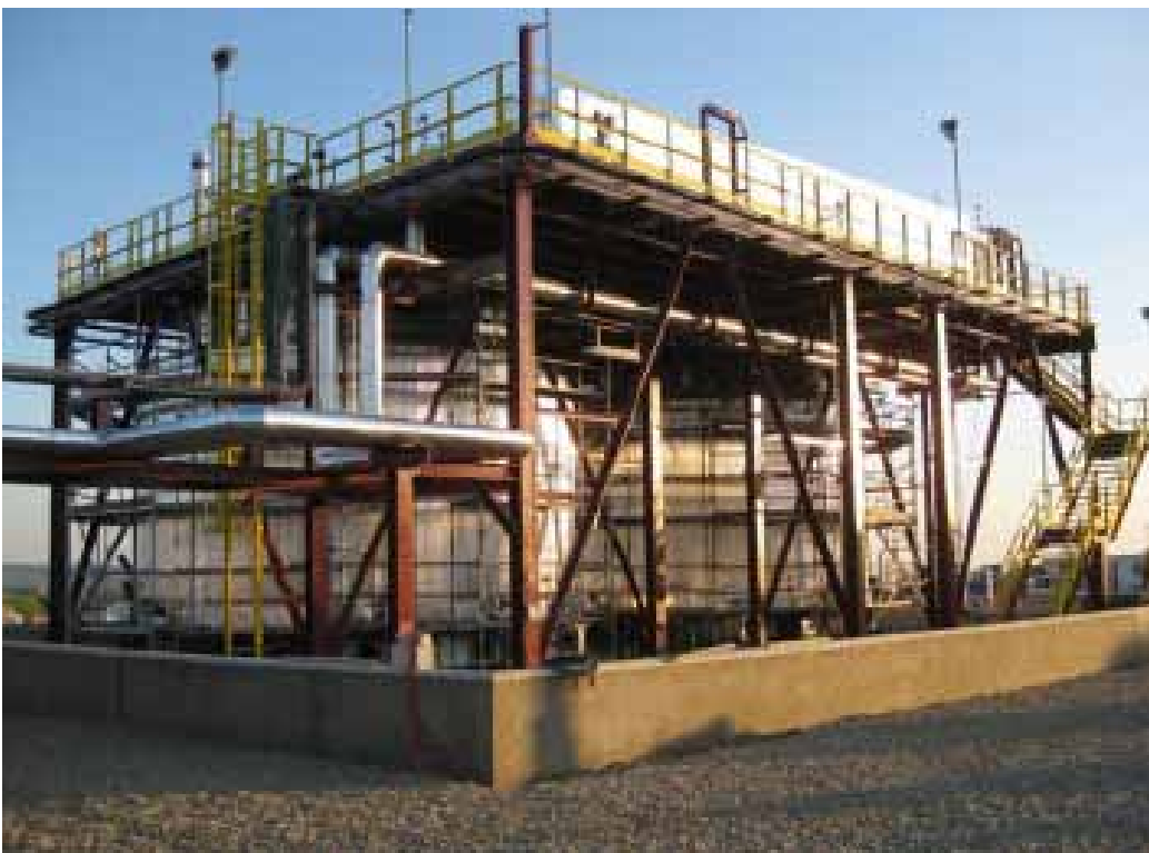
Planta piloto de almacenamiento de sales fundidas, en operación desde 2009 en la Plataforma Solúcar, Sevilla
