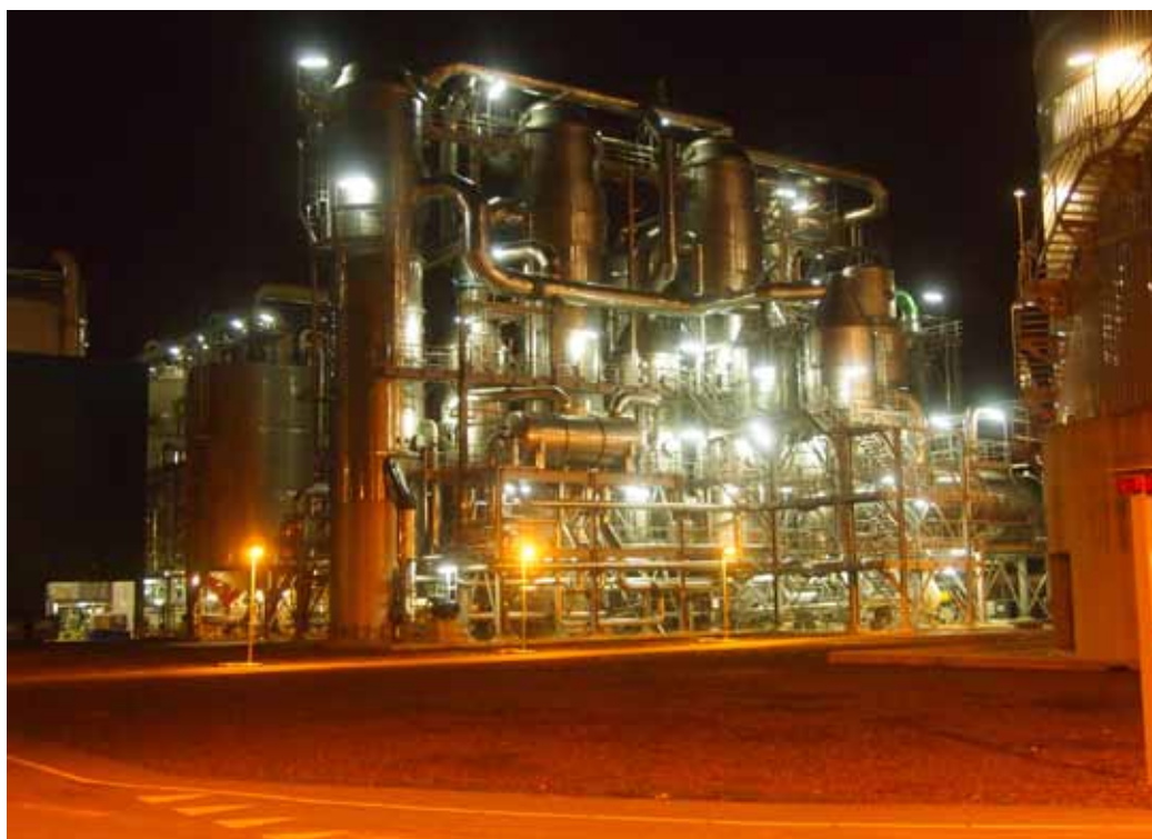
Refinería de Repsol donde Nicsa suministra material
