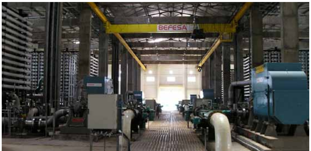
Interior de la desaladora Chennai, India
