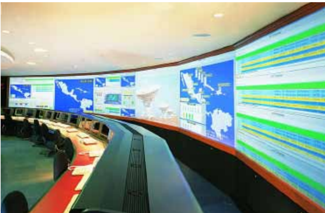
Centro de control Pemex
