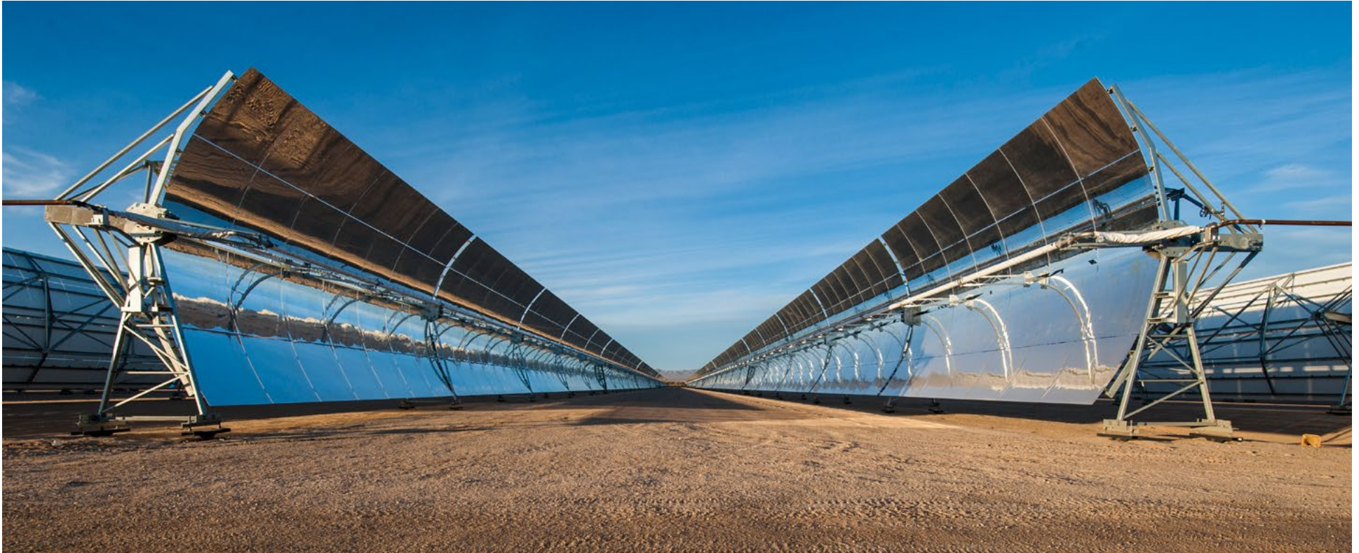
Mojave Solar, la segunda planta cilindroparábólica más grande del mundo, entró en operación 2014
