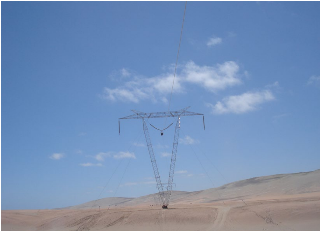
Abengoa opera la línea de transmisión eléctrica más larga de Perú
