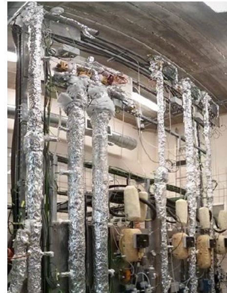
Unidad piloto de separación y purificación de butanol
