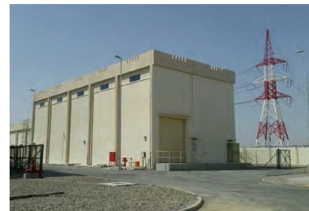
Abengoa ha puesto en servicio la subestación de Al Dreez de 132/33 kV.
