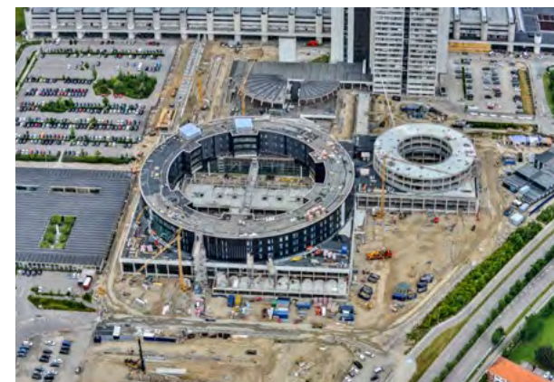
Abengoa desarrolla las instalaciones electromecánicas de un complejo hospitalario en Herlev (Dinamarca).
