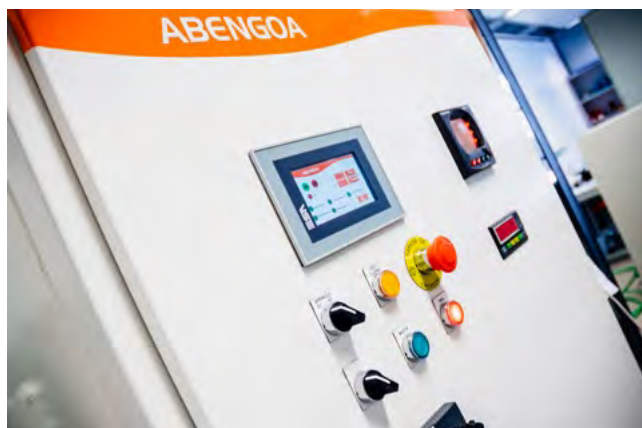
Convertidor de motores eléctricos de 100 MW.
