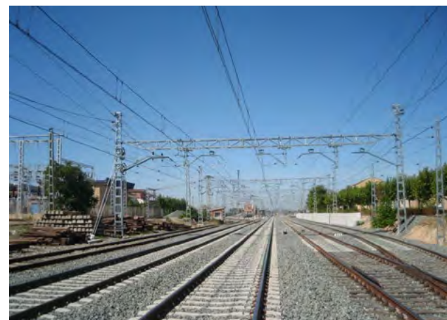
El proyecto HVDC permitirá desarrollar sistemas de electrificación ferroviarios de HVDC para líneas de alta velocidad.
