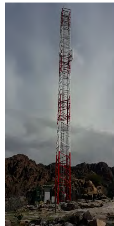
Imagen de los trabajos desarrollados por Abengoa en Marruecos para Orange.
