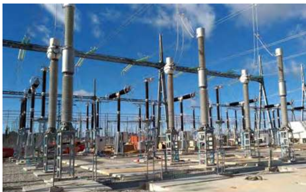
Subestación de 400/22 kV que Abengoa está desarrollando en ITER.
