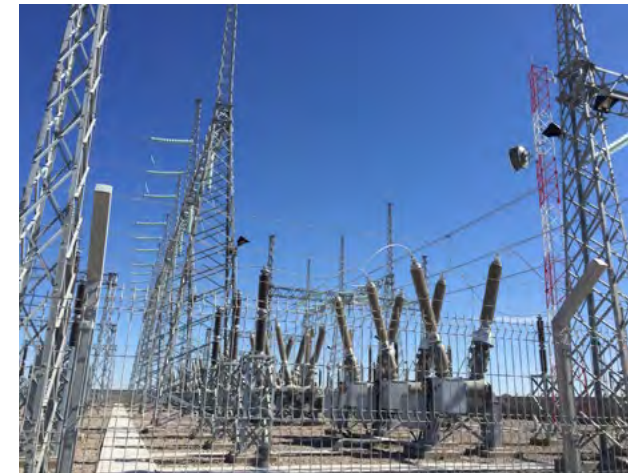
Estación seccionadora del proyecto Atacama I, del complejo solar Cerro Dominador.
