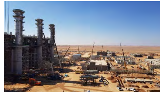
Imagen de los trabajos que Abengoa está desarrollando en Arabia Saudí de la planta Waad Al Shamal.
