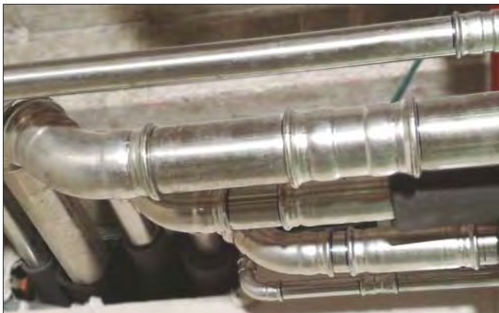
Tuberías de acero inoxidable.
