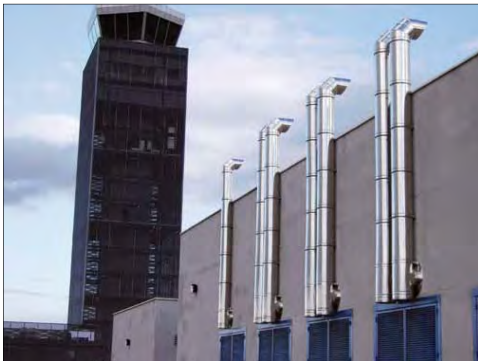
Chimeneas fabricadas con acero inoxidable en el Aeropuerto de Ciudad Real.
