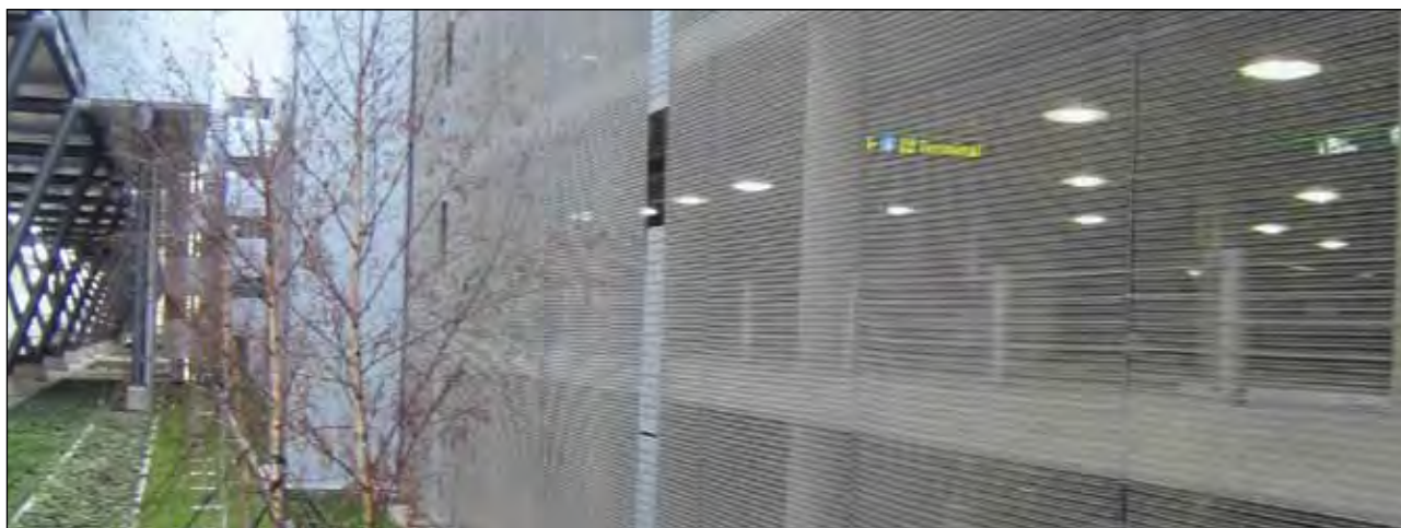
Malla de acero inoxidable en las instalaciones del Aeropuerto de Madrid.
