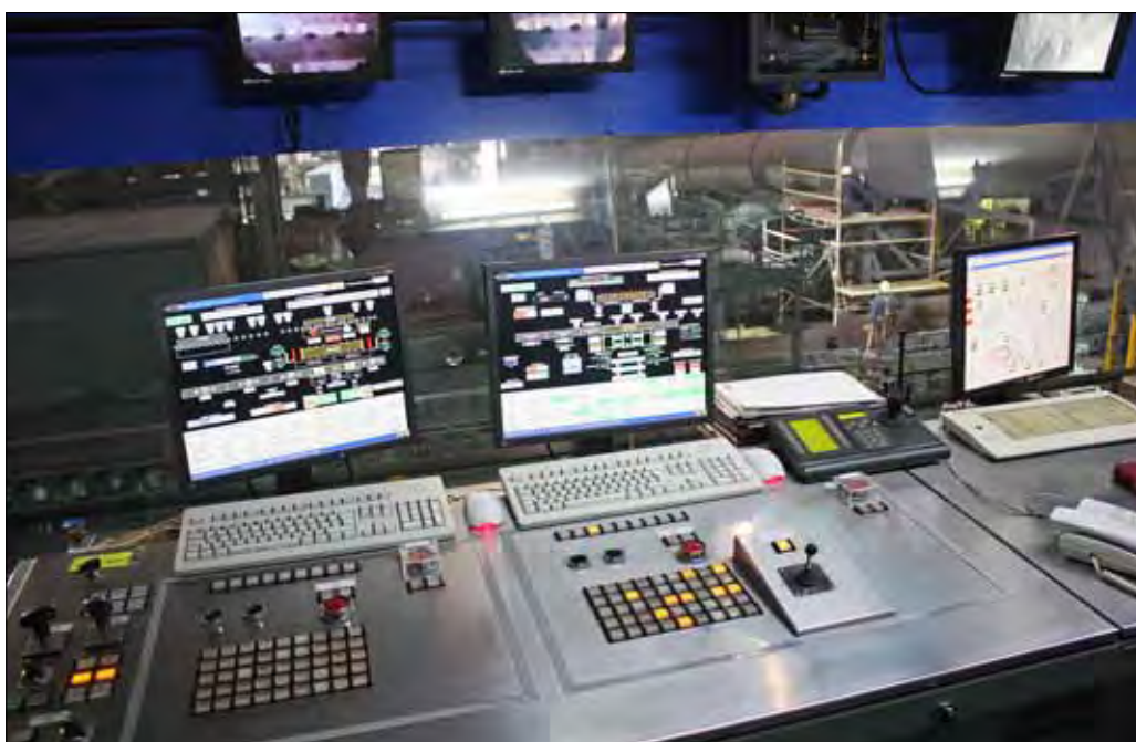
Puesto de control de línea de proceso.
