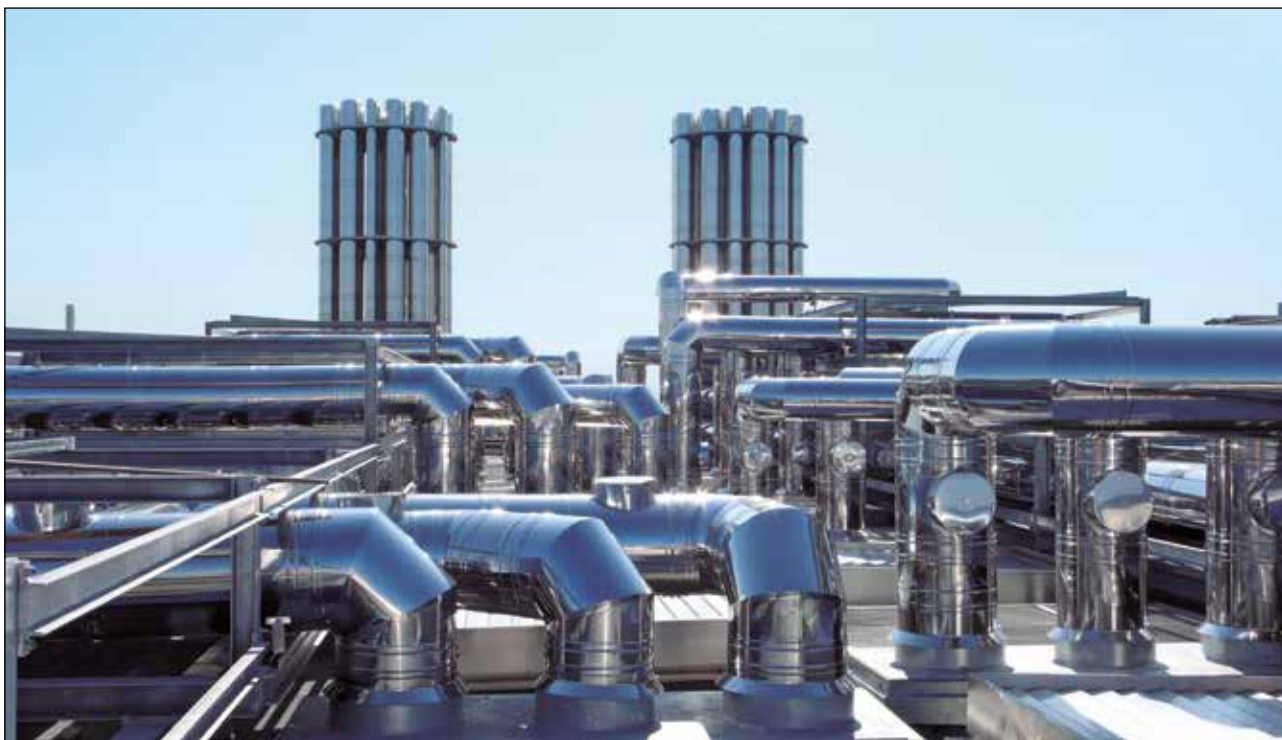
Sistema de evacuación de humos fabricado con acero inoxidable
