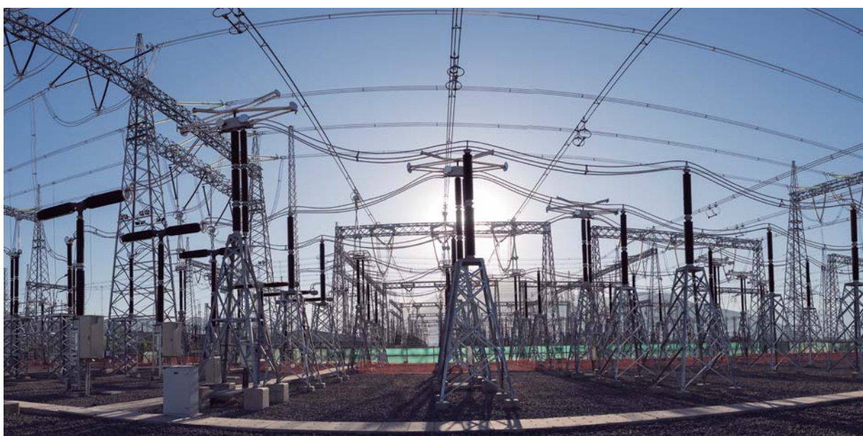
Subestación Alto Jahuel 500 kV (Chile)
