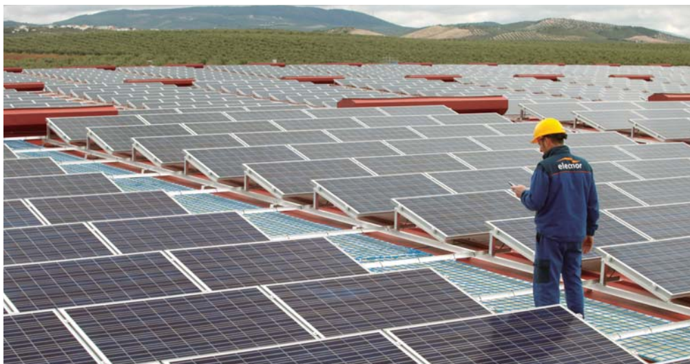
Cubierta fotovoltaica en nave de Puertas THT en Antequera (Málaga)
