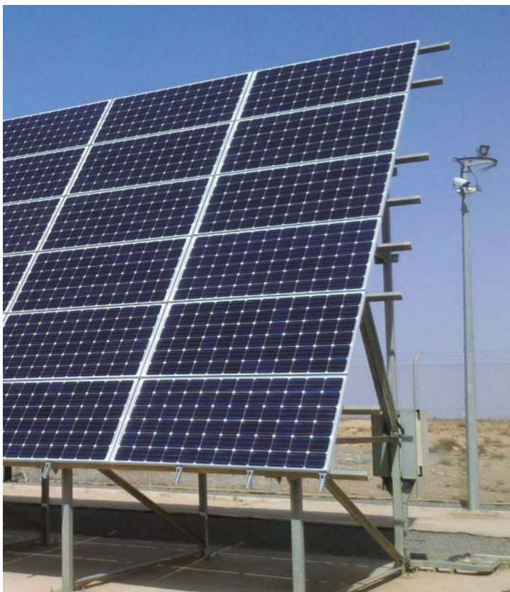
Instalación solar para protección catódica y control de válvulas de gasoducto. Remodelación gasoducto Metragaz (Marruecos)
