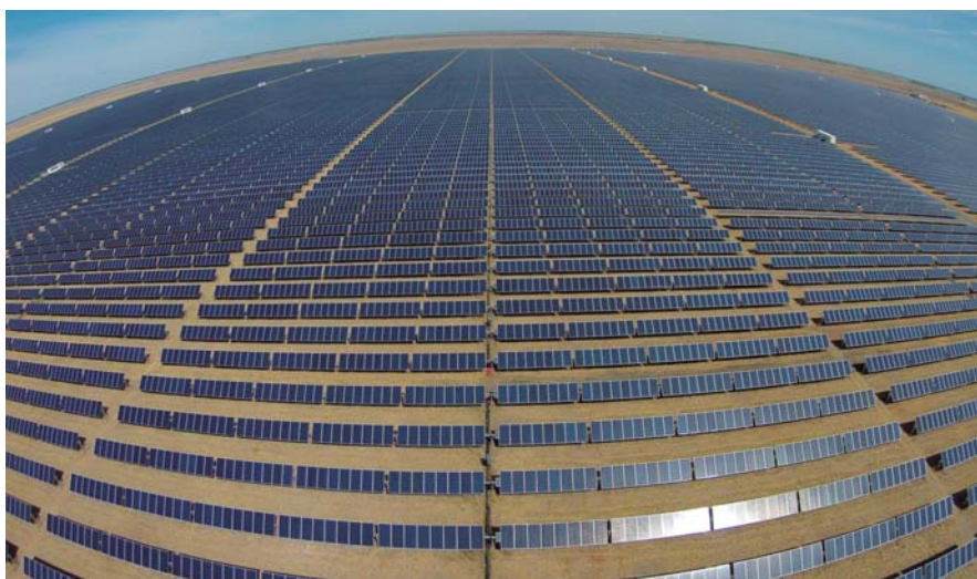
Parque solar fotovoltaico Moree (Australia)
