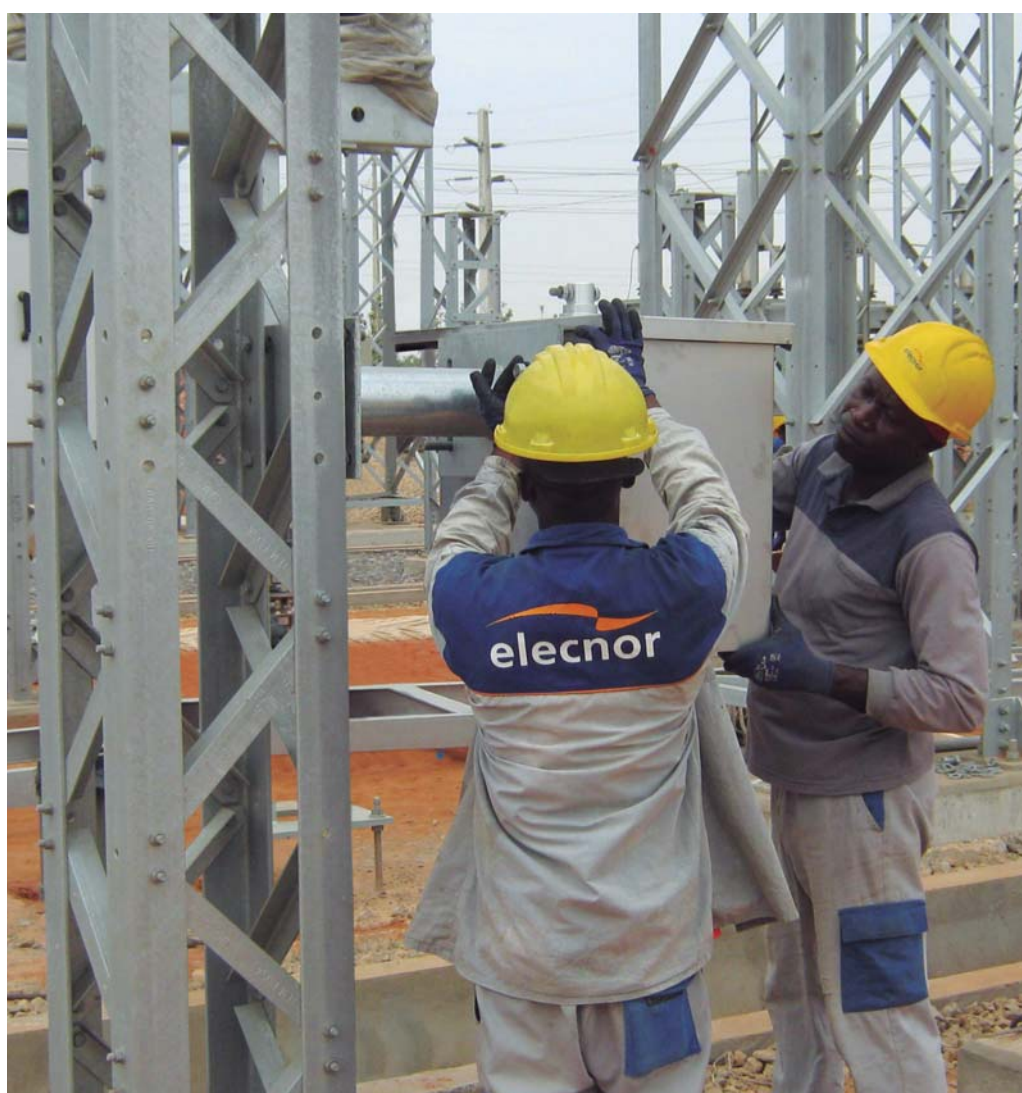
Ampliación de la subestación Camama 220/60 kV (Angola)
