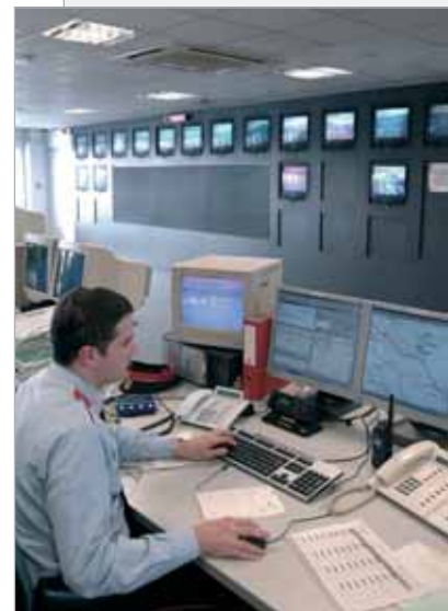
Sala de Control de la red RESCAT
