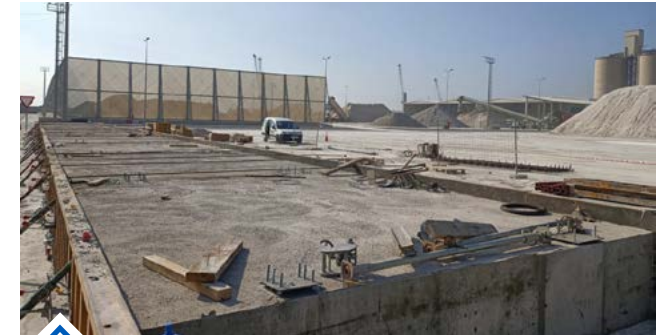
PortCastelló instala pantallas atrappolvo en la dársena sur
