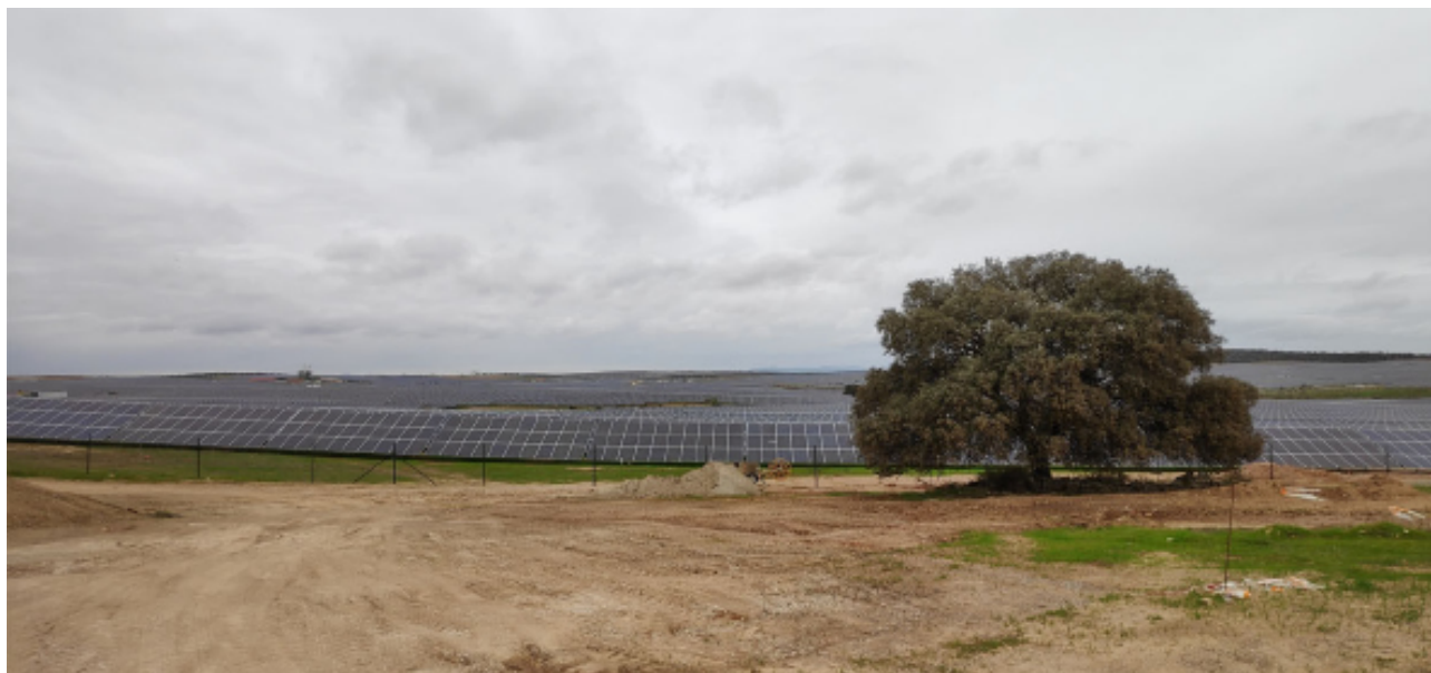
Central fotovoltaica Francisco Pizarro - Cáceres, España
