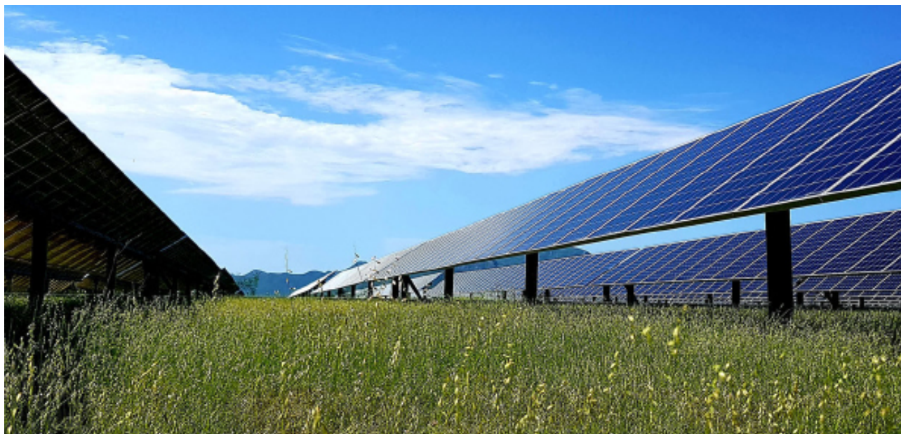
Central solar fotovoltaica de Hermosillo – Sonora, México
