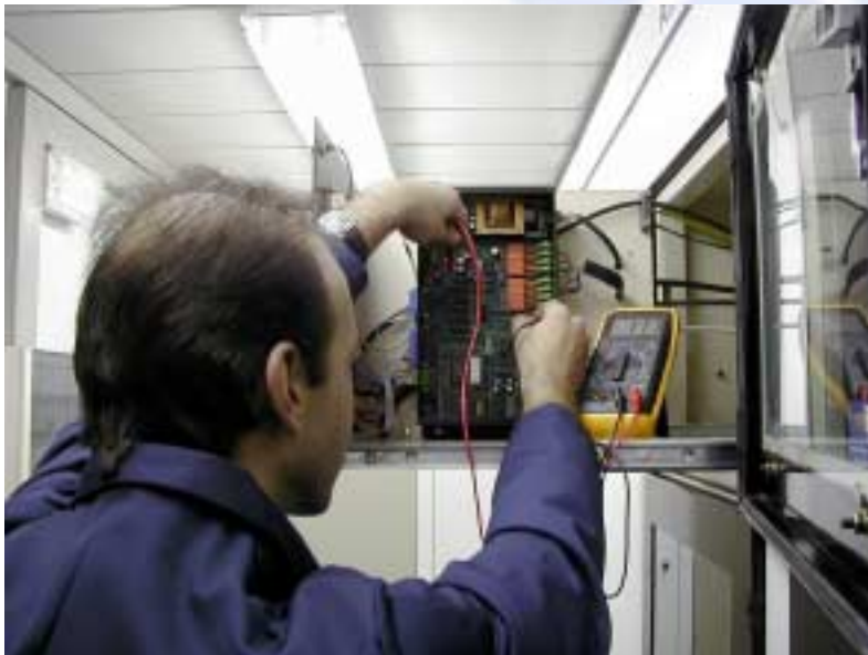
Mantenimiento de automatismos.
