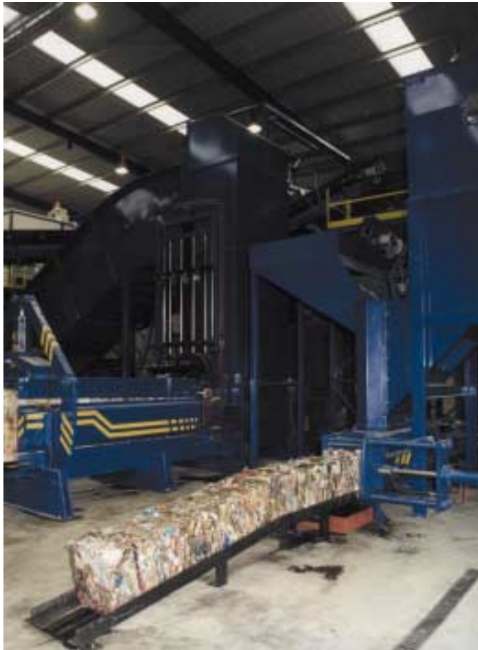
Planta de selección. Centro de reciclaje de la mancomunidad de la Vega en Alcalá del Río (Sevilla)
