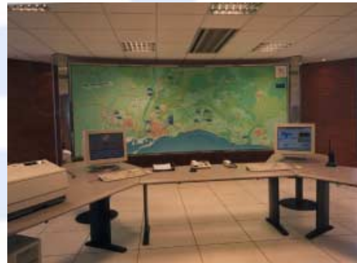
Centro de control y telecomando del Servicio de Aguas de Tarragona, ubicado en las instalaciones de Ematsa en la montaña de Sant Pere
