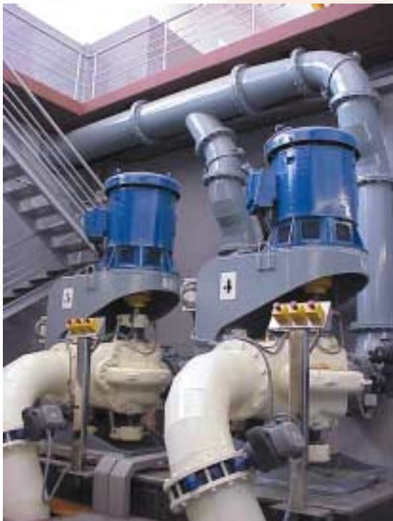
Bombeo cota 70 Sant Joan Despí
