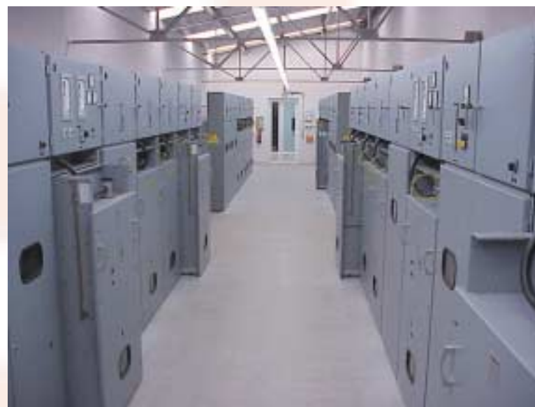
Interior estación transformadora y de maniobra de Cornellà
