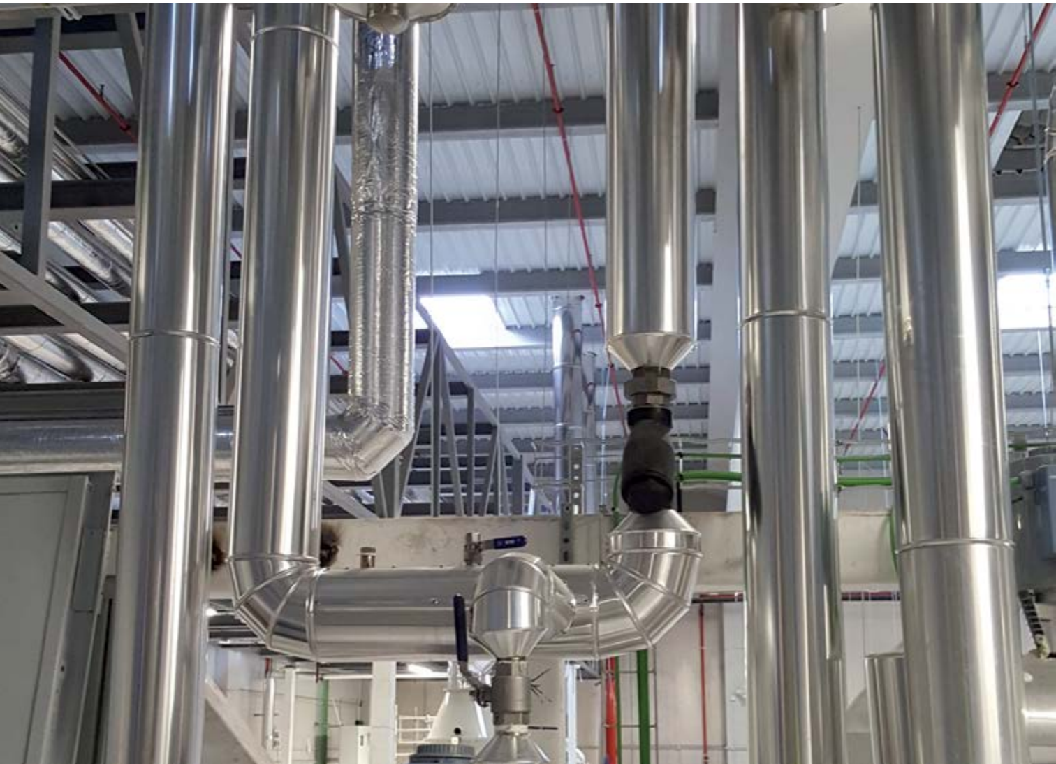
Fábrica Nueva Bureba de Campofrío, Burgos (España)
