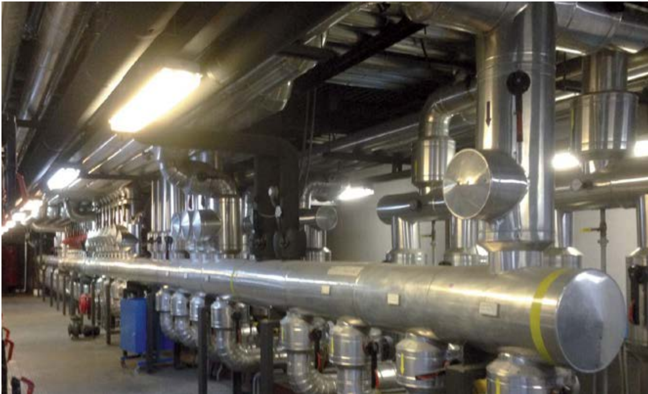
Adecuación de Central Frío/Calor en edificio Corporación de Radio Televisión Española en Prado del Rey, Madrid (España)
