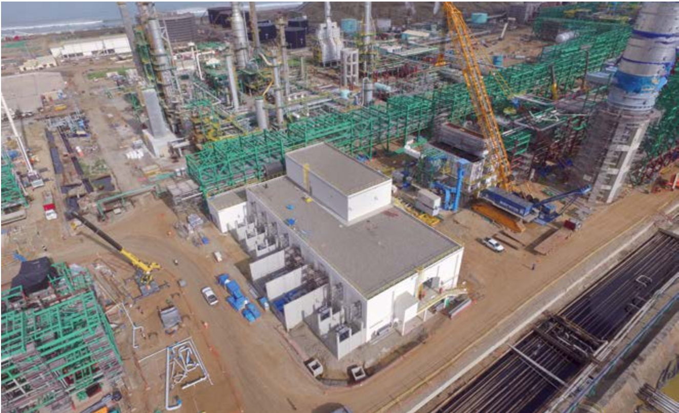
Edificios de Control y Subestaciones Eléctricas. Refinería Talara - Piura (Perú)
