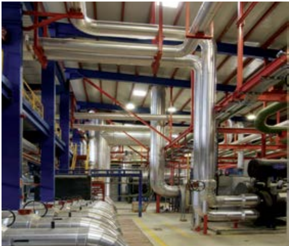
Suministrador de energía eléctrica y térmica de todo el complejo, incluido el primer acelerador de partículas de España y del suroeste de Europa: Sincrotrón Alba.
