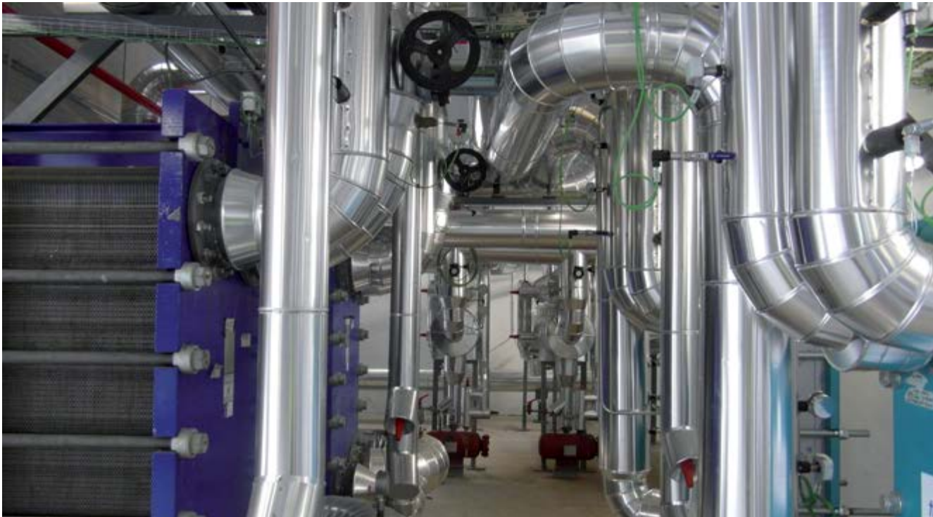
Fábrica Nueva Bureba de Campofrío, Burgos (España)
