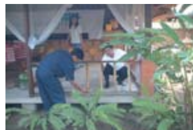
Los empleados del departamento de mantenimiento del hotel Meliá Benoa (Indonesia) colaborando en la reforma de Kupu-Kupu Fondation .
