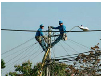
Cuadrilla de Chilectra trabajando para restablecer el servicio eléctrico de la capital.
