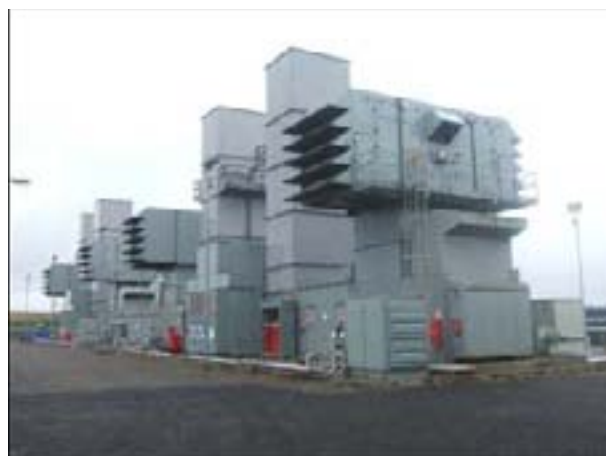
Central térmica de Rhode (Irlanda).
