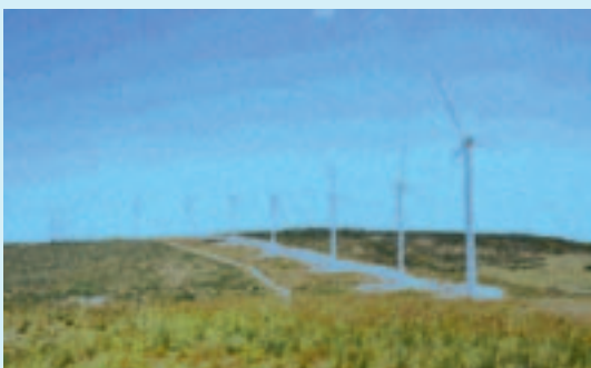
Parque eólico de Valdehuelo, Ávila
